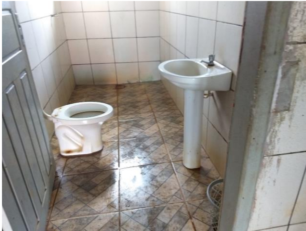
Foto 9: Banheiros sem um piso adequado
