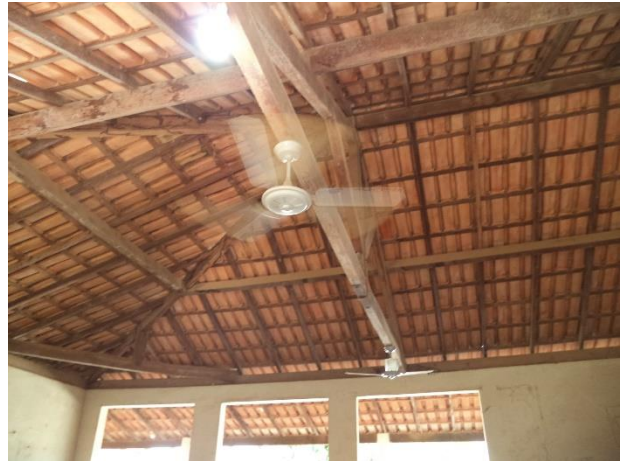
Foto 10: Salas sem forro e estrutura de cobertura apresentando problemas
