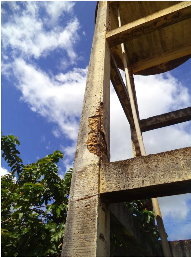
Foto 5: Estrutura da caixa d'água apresentando problemas na estrutura
