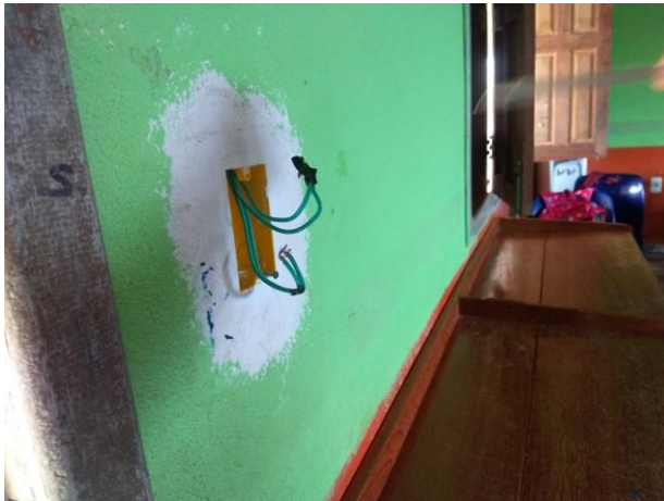
Foto 11: Instalações elétricas expostas e danificadas.
