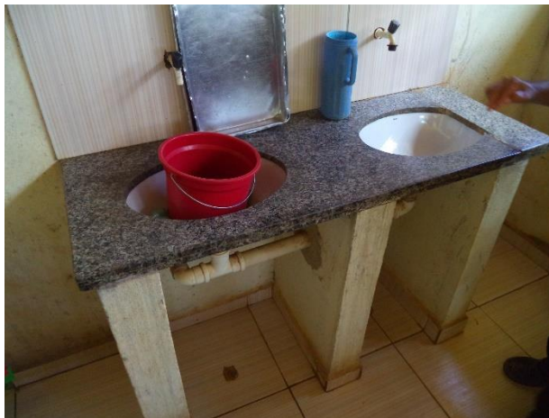
Foto 3: Problemas nas pias da cozinha
