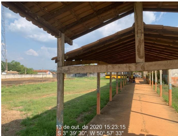
Foto 7: Parte da passarela apresentando problemas
