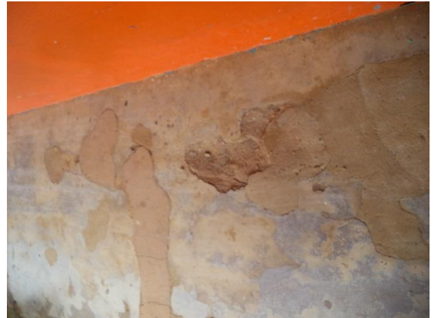
Foto 6: Descamação e parte do reboco saindo
