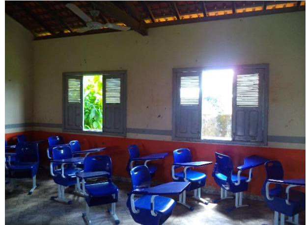
Foto 2: Iluminação insuficiente, infiltrações nas paredes e forro inexistente.
